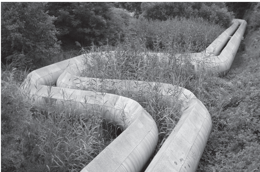
Obr. 5. Sítí potrubí jen výjimečně prochází povrchem. Teplovod v Bratislavě. Foto: L. Jašicová
